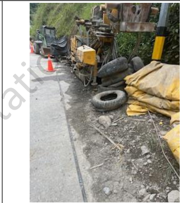
Foto 51: Gestión inadecuada de los residuos
