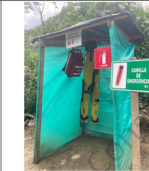
Foto 50: Equipo de emergencia en el sitio de construcción de la casa de máquinas
