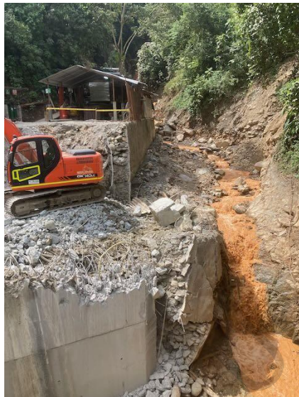
Foto 61: Pesada carga de sedimentos del arroyo en el portal inferior del túnel, causada por la falla del
