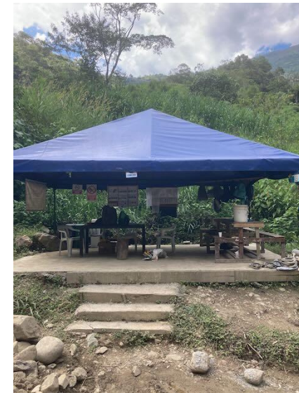
Foto 63: Área de descanso para los trabajadores en la obra de construcción de la central eléctrica
